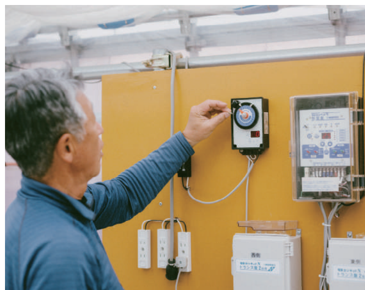
▲ハウス内に設置した操作盤で水や養液の制御を行います。簡便なシステムが気に入っています。
